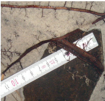
Bild 1: Durchwurzelter Konstruktionsbeton hinter einer Auskleidung (Foto: P & T-Kerasal)
